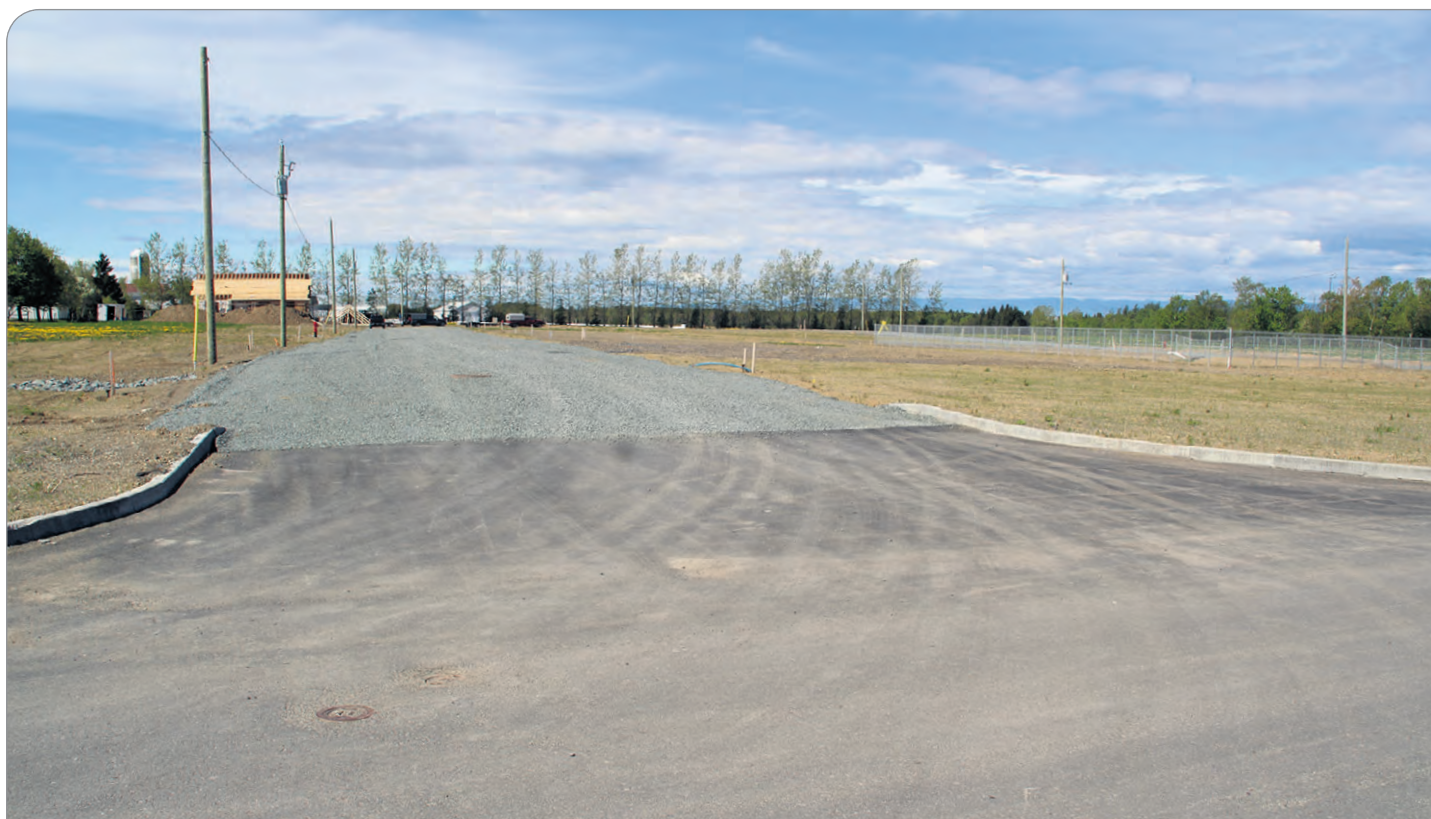
On s'active déjà à la construction des premières maisons dans ce nouveau développement domiciliaire. PHOTO : HUGUES ALBERT
