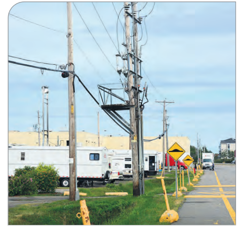
L'installation électrique est située à l'arrière du Centre commercial de Rivière-du-Loup, entre le boulevard de l'Hôtel-de-Ville et la rue des Marguerites. PHOTO : ANDRÉANNE LABEL
